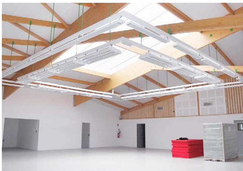
Инфракрасные обогреватели – это оптимальное решение для обогрева периодически используемых помещений. Смелое дизайнерское решение делает компоновку систем освещения и обогрева самостоятельным архитектурным элементом.
